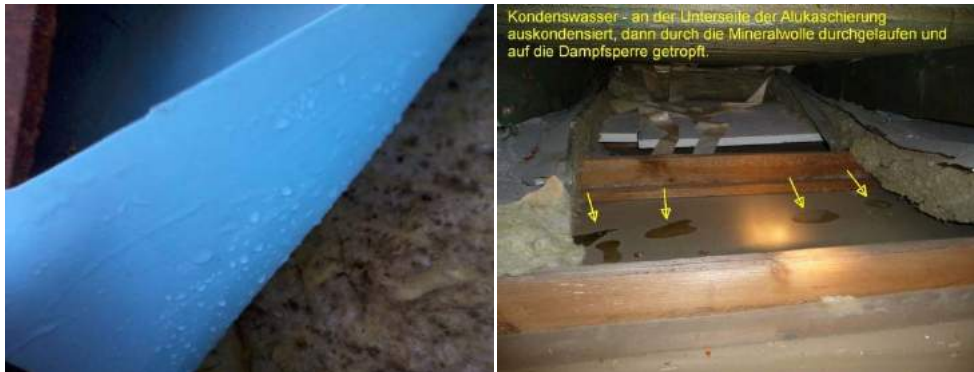
Abbildung 1: Tauwasser bei Mineralwolldämmung unter dampfdichte Dächern
