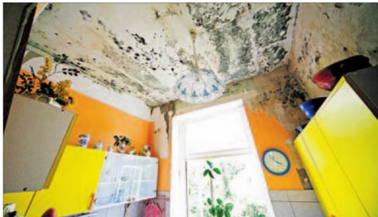
Kochen unter Schimmelsporen: Nach dem Feuer blieben die Spuren des Löschwassers der Feuerwehr auch in der Küche zurück. Foto: Ove Arscholl
